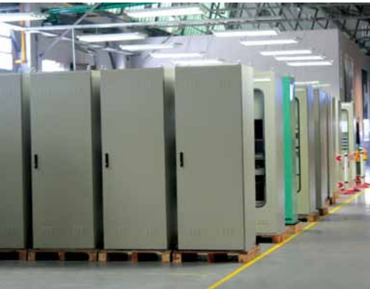
Sturba: Alejandro Sturba, gerente de Ingeniería de Protecciones, Control y Comunicaciones de la empresa, ofició de guía por las nuevas instalaciones de ABB.
