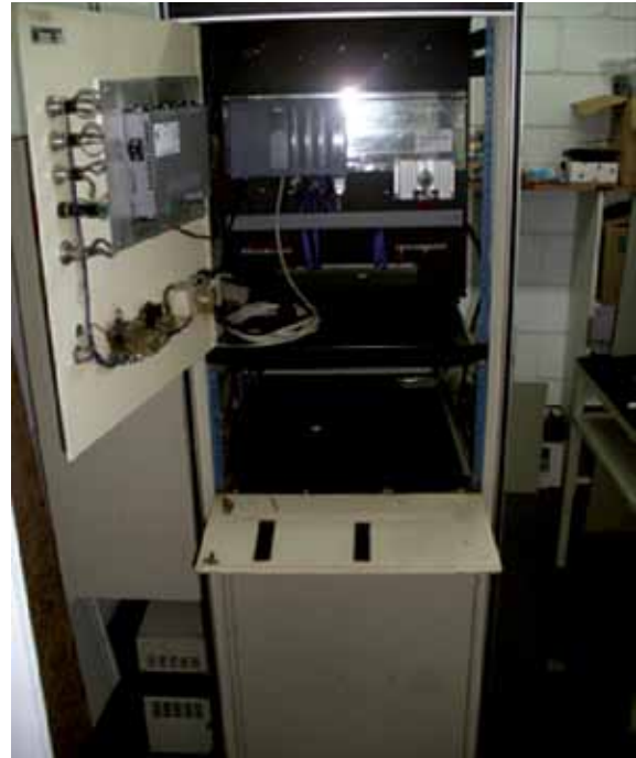
Figura 13. PLC y HMI instalados en la consola original del banco de ensayos
