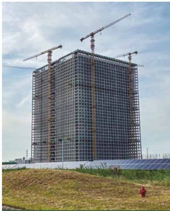
Figura 1. Torre de Energy Vault, primera batería gravitacional comercial del mundo, ubicada en Rudong, Jiangsu (China)
