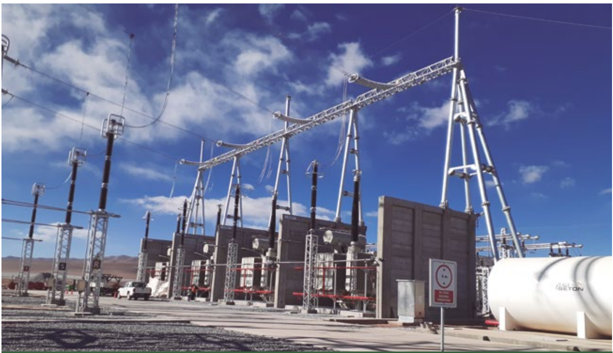
Subestación transformadora del Parque Solar Cauchari
