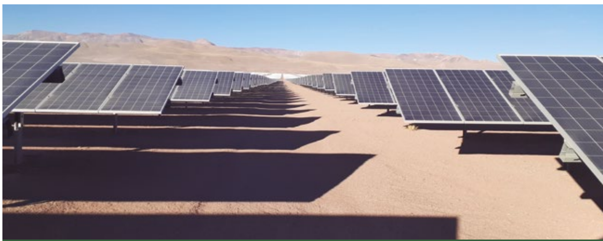
Paneles solares desde subplanta Fuente: Manuel Arequipa
