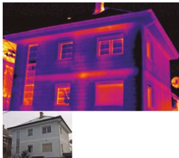
Figura 1. Detección de fallos en la construcción
