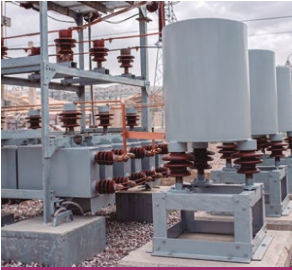
Figura 8. Filtros de armónicas de media tensión Imágenes generadas con Gemini a partir de imágenes reales
