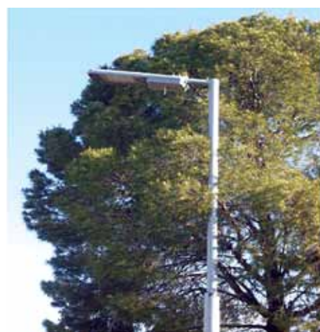
Figura 9. Luminaria instalada en columna metálica
