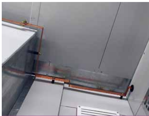
Figura 15. Barra de puesta a tierra perimetral interna superior
