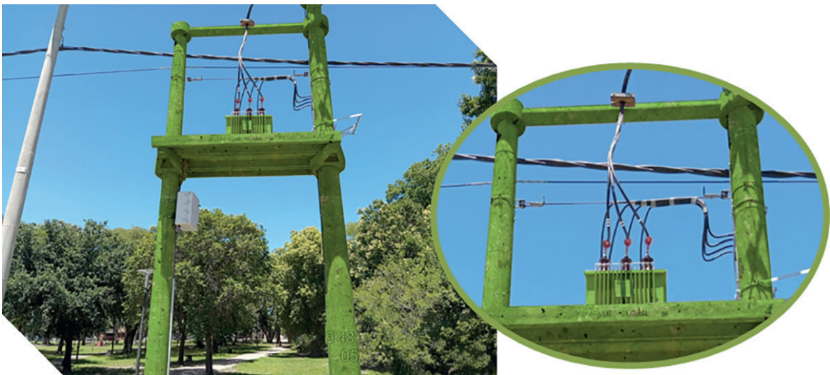
Figura 5. Antena y transformador de aluminio, con aceite vegetal y estructura de hormigón reciclado
